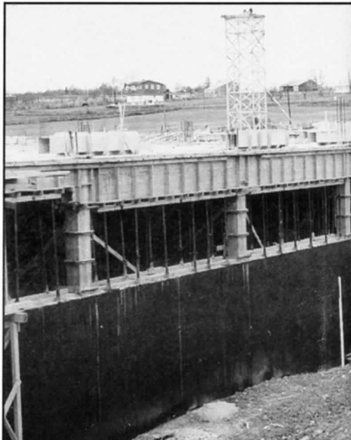
En décembre 1959, toutes les fondations étaient terminées avant l'arrivée du grand froid.
